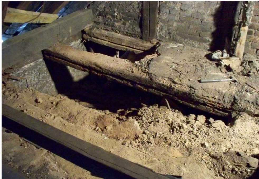
Bild 3: Geöffneter Fußboden der Wohnung oberhalb des Chorraums, Blick in das Chorgewölbe begrenzt durch den Schutt
